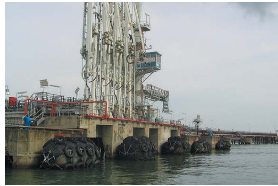
LNG Terminal \phi 3300 \times 4500L
